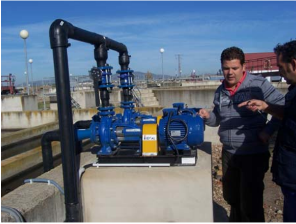
ELECTROBOMBAS DE IMPULSIÓN DEL AGUA DE LA EDAR
