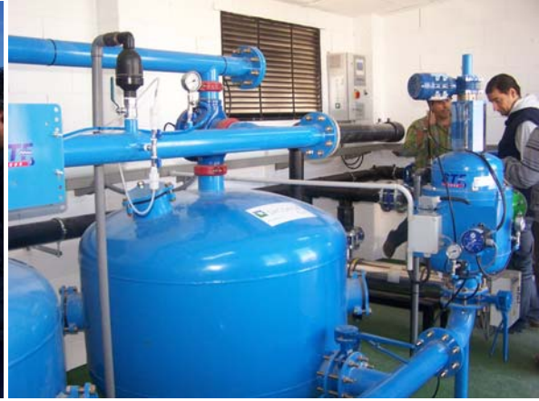
FILTROS DE ARENA
